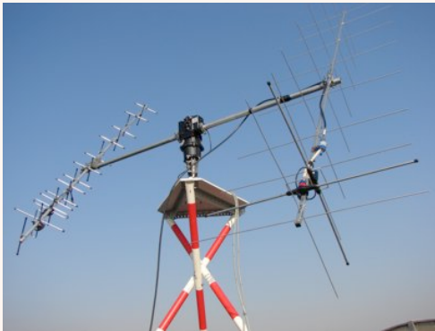
Une partie des antennes
