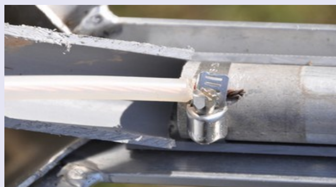
l'âme du câble est accrochée par un collier
